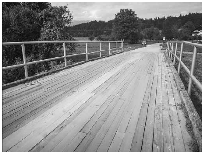
Mlinarjev most je v precej slabem stanju, zato je v načrtu obnova. (Foto: Nastasja Kotnik)
